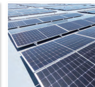
■埼玉県 総発電電力量 500kW
