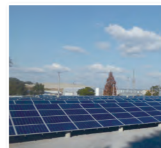
■大分県 総発電電力量 336kW
