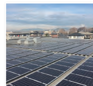
■埼玉県 総発電電力量 197.16kW
