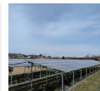
■埼玉県 総発電電力量 52kW
